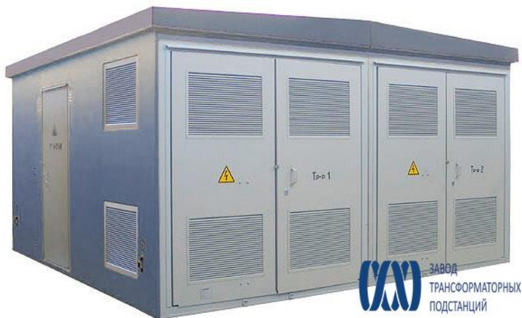
Рисунок 2.1 – Внешний вид подстанции
