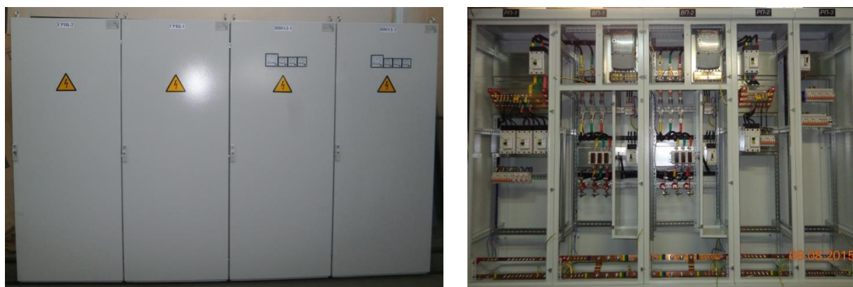
Рисунок 2.2 – Внешний вид вводно-распределительного устройства
